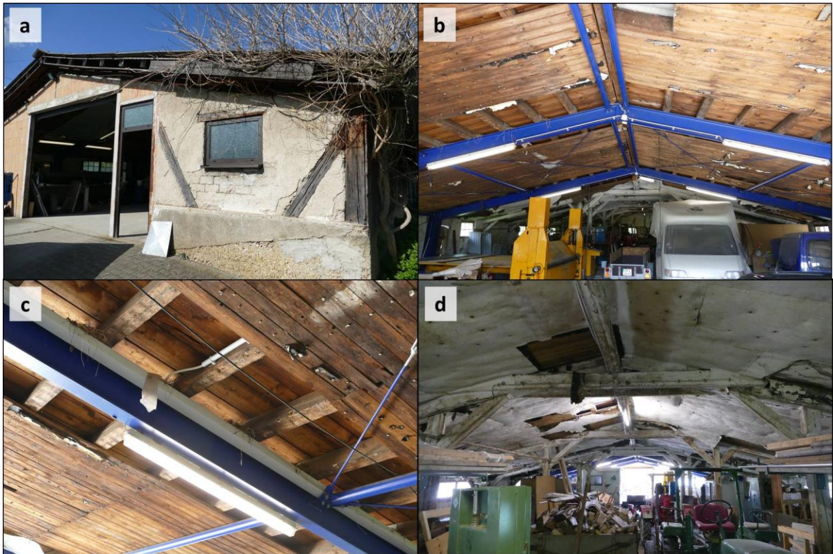
Abb 5: Untersuchung des langen Schuppens. a) Blick auf die Eingangstür. Der Schuppen ist aktiv als Werkstatt und Lager genutzt und wird täglich benutzt. b) Blick in den Schuppen mit zahlreichen Fahrzeugen und Maschinen/ Werkzeugen im vorderen Teil. Das Dach ist im vorderen Teil nicht verkleidet. c) Detailaufnahme des Daches im vorderen Teil. Auf den Balken sind (verlassene) Nester zu sehen. d) Blick in den hinteren Teil des Schuppens, der primär als Lager genutzt zu werden scheint. Das Dach ist hier innen verkleidet. Laut Aussage der Besitzer wohnen Marder im Dach. Fotos: Dr. B. Schalkhaußer
