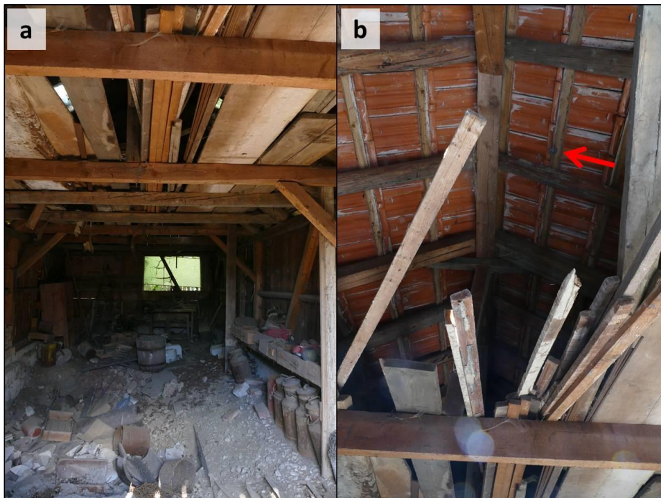
Abb 4: Untersuchung des kleinen, verfallenen Schuppens. a) Blick in den Schuppen mit aufgerissenen Boden und Einflugmöglichkeiten für Fledermäuse. Der Schuppen wirkt ungenutzt und sich selbst überlassen. b) Detailaufnahme des Daches von innen. Der rote Pfeil markiert eines der Wespennester. Fotos: Dr. B. Schalkhaußer
