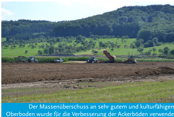
Die beauftragte Firma STRABAG aus Kirchheim hat mit den Erdarbeiten zwischen der Grünenberger Straße und dem Ortsausgang Richtung Kuchen begonnen
